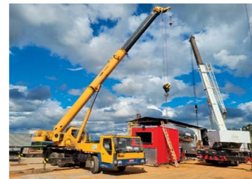
Instalação de nova caldeira a lenha de eucalipto
